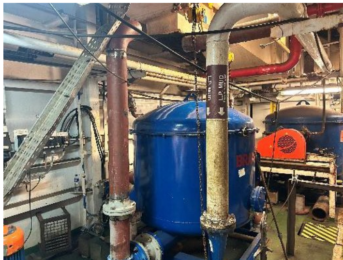
Figura 9 — Vasos do degaseificador a vacuo existentes in-situ antes da remocao, mostrando a tubulacao do sistema LP Mud e o layout dos equipamentos ao redor
